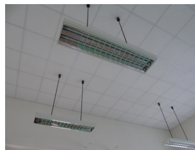
Figura 8.9 - Particolare impianto illuminazione su cui intervenire.
