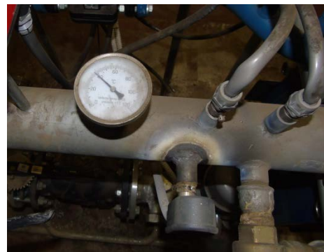
Figura 4.8 – Particolare della sonda di temperatura sulla tubazione di mandata
