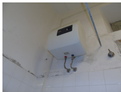
Figura 4.13 - Particolare del bollitore elettrico ad accumulo per ACS
