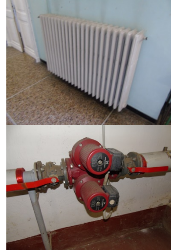
Figura 8.7 – Particolare sistema di emissione e circolatori da sostituire
