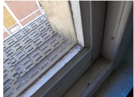
Figura 8.1 - Particolare serramenti da sostituire.
